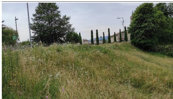
Prima degli interventi
